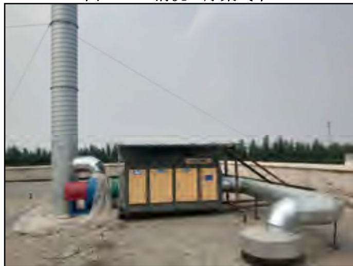
图 6 清洗工序光氧催化设施及排气筒
