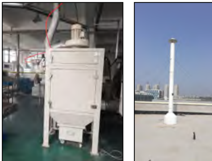
图 4 喷砂工序滤芯除尘器及排气筒
